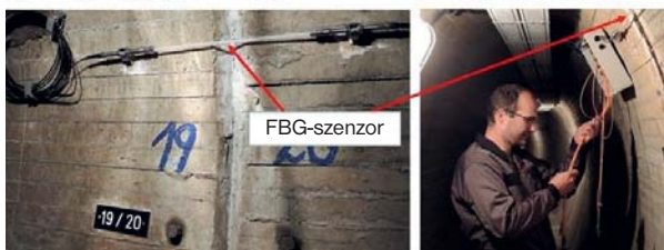
9. ábra. FBG-érzékelővel monitorozott gát Ausztriában
